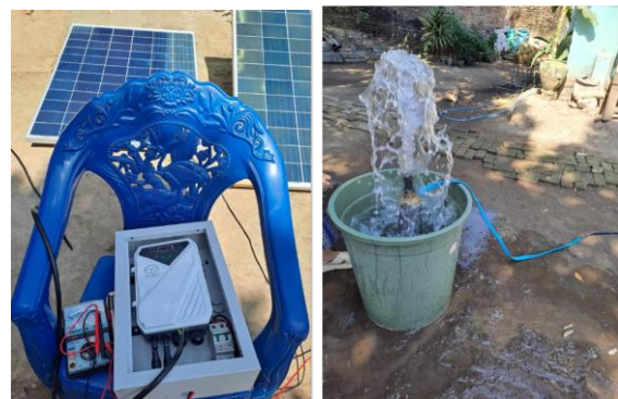
Gambar 6. Ujicoba Pompa, panel surya dan controller
